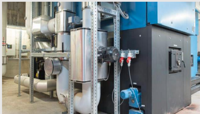
Holzheizkessel des Wärmeverbundes Lenzerheide
