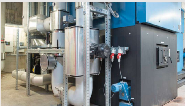
Holzheizkessel des Wärmeverbundes Lenzerheide
