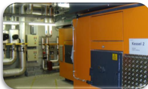
2. Holzheizkessel in der Heizzentrale
